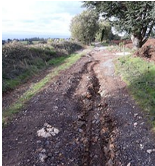
État très dégradé
