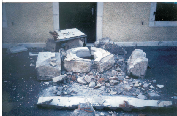
Halte garderie de Metz-Tessy Fronton de lucarne effondré
