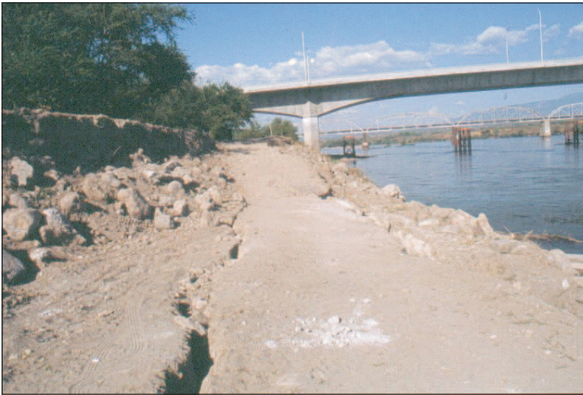
Photographie 14 : Glissement latéral sur la rive droite de la rivière Lempa, séisme du 13 janvier 2001 au Salvador
