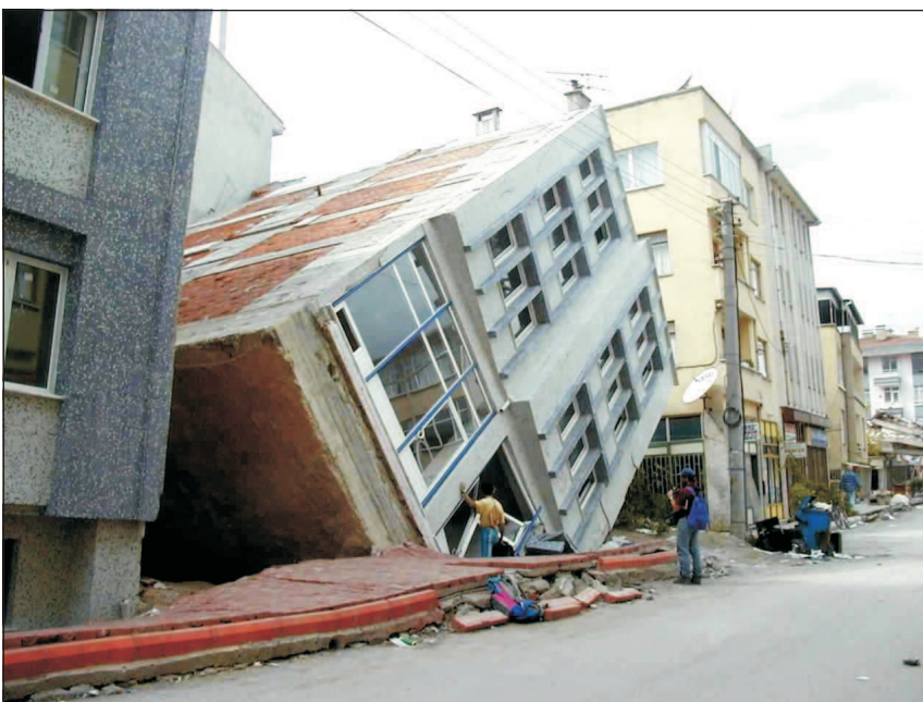
Photographie 10 : Conséquence de la liquéfaction sur un immeuble à Adapazari, séisme d'Izmit, Turquie, 1999
