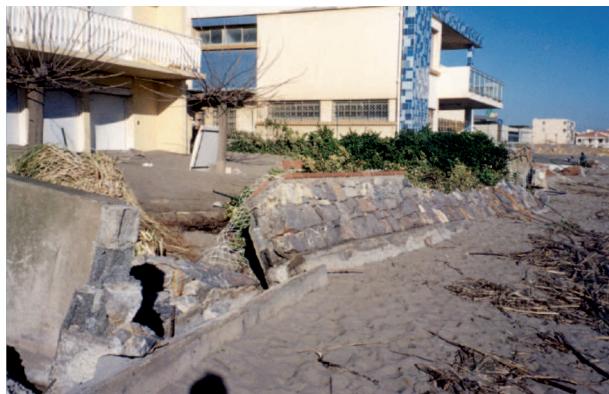
Érosion des côtes sableuses à Valras (Hérault)
